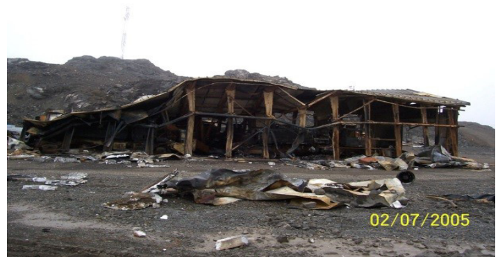
Constatación de daños post incendio cuartel SSEI.
